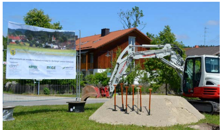
Im oberbayerischen Moosach wird in Zukunft nachhaltig geheizt. Die Verlegearbeiten begannen im Mai
