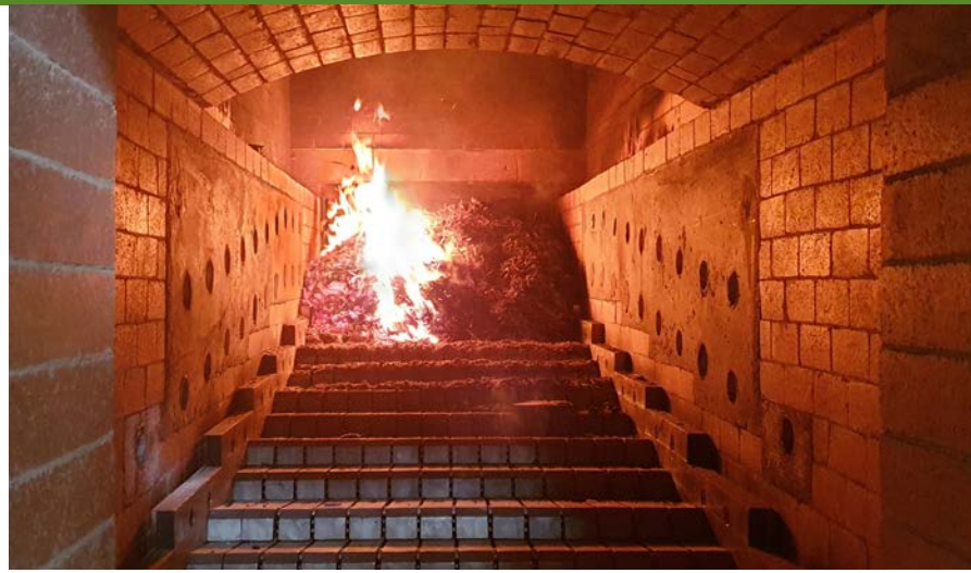
Was aussieht wie ein Pizzeriaofen zeigt in Wirklichkeit das Innere des Kessels in der Energiezentrale in Forchheim
