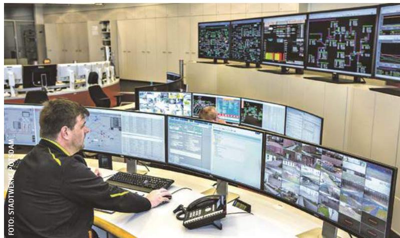
In vielen Bereichen hat die Digitalisierung längst Einzug gehalten, wie hier im Leitstand des Heizkraftwerkes Süd in Potsdam
