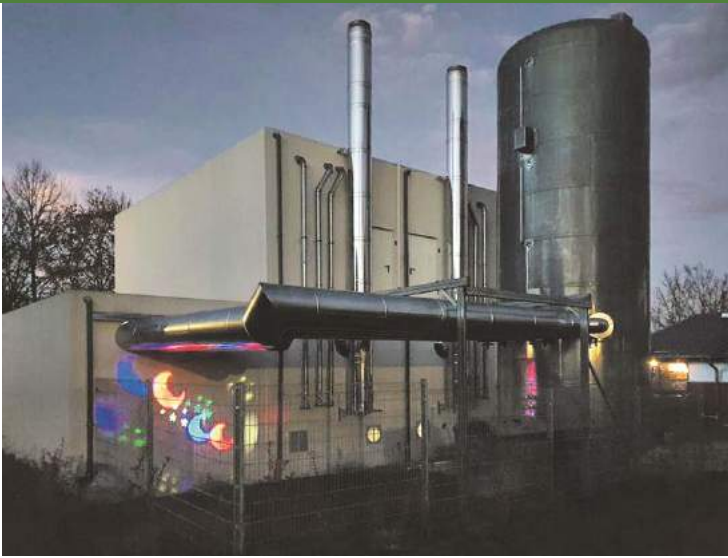
Lichtinstallation an der kleinen Energiezentrale
