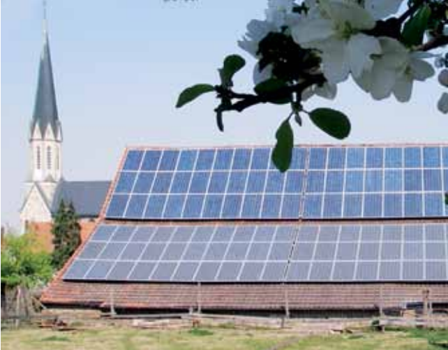
Photovoltaik-Anlage auf Scheune im Ortskern
