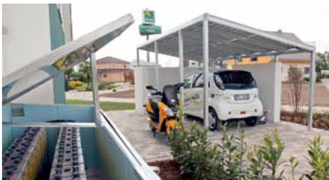
Solarstromspeicher und E-Auto vor dem Energieautarken Haus
