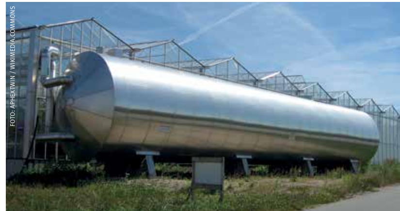
Puffer-Heißwasserspeicher für Gewächshausanlage mit 150 m 3 Volumen
