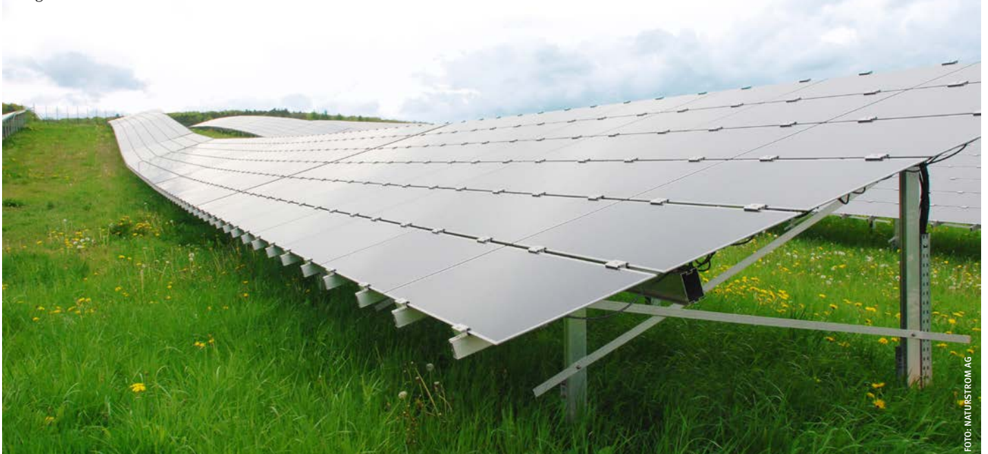
NATURSTROM-Solarpark in Oberreidenbach
