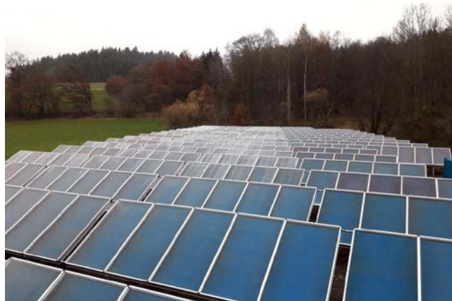
Ein Plus für den Klimaschutz: Die 1.067 m 2 große Solarthermieanlage erzeugt künftig 100% erneuerbare Wärme
