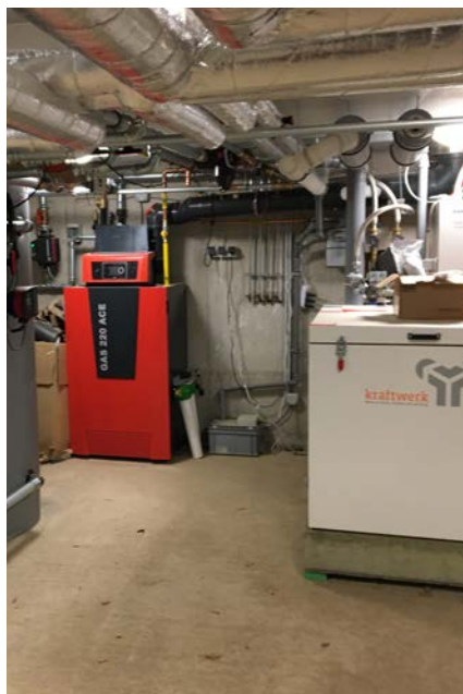
BHKW, Gaskessel und zwei Pufferspeicher versorgen das Quartier mit nachhaltiger Wärme
