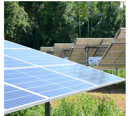
Energiewende zum Anfassen: Ein Besuch der NATURSTROM-PV-Freiflächenanlage in Eggolsheim stand beim BEGImpuls auch auf dem Programm
