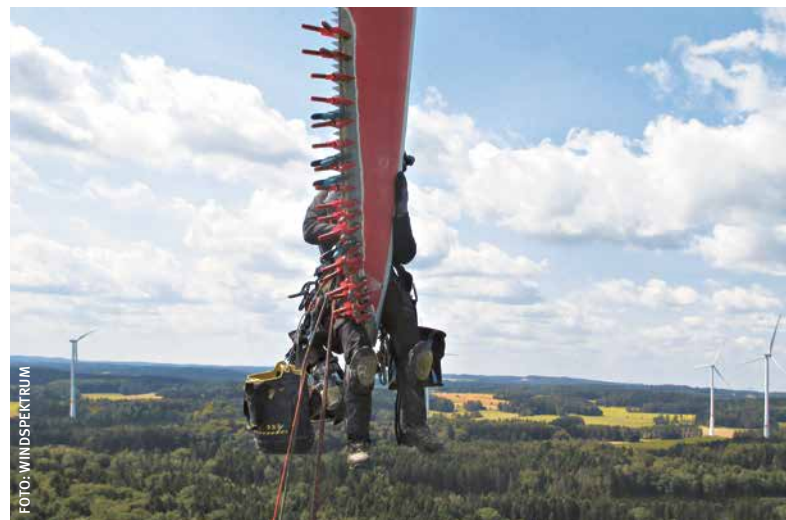
Bei Schäden an den Rotorblättern braucht es Experten mit Seilzugangstechnik, die in schwindelerregender Höhe ihr Werk vollbringen
